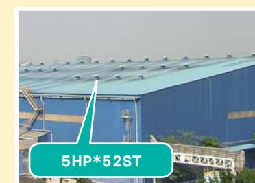
L3 廠房抽風機
