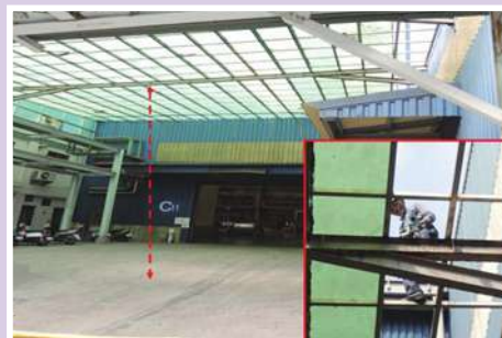
高處作業防墜設施不足
