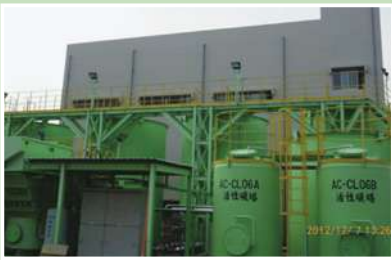
清洗線廢水處理場
