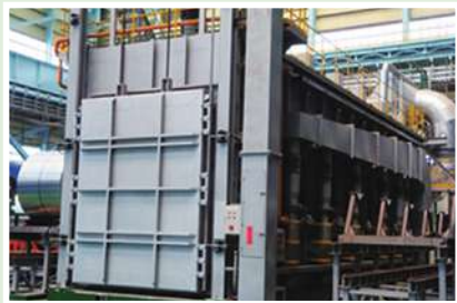
二階擴建節能軟燒爐
