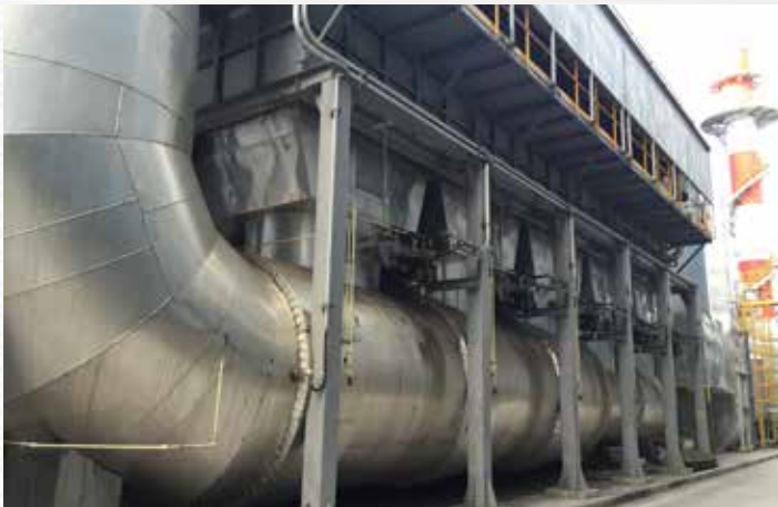
RTO 蓄熱式燃燒器
