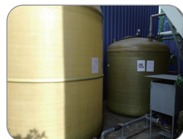
FPL新增鹼高低濃度暫存槽
